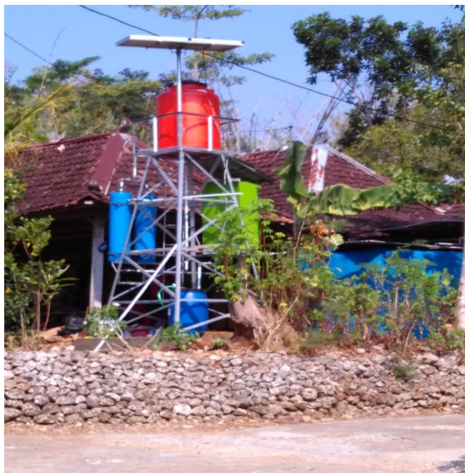
Gambar 10. Alat pengolahan air bersih guna menurunkan kadar kapur
