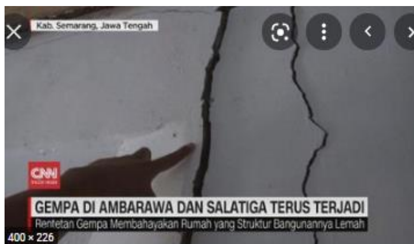
Gambar. 2 Retakan besar akibat gempa Ambarawa. Sumber: BMKG
