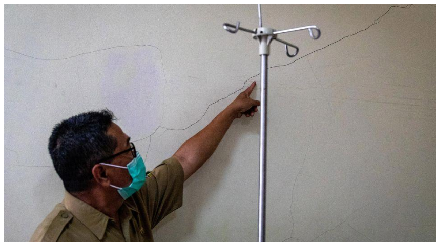
Gambar. 1 Retakan kecil pada RSUD Ambarawa. Sumber: BMKG
