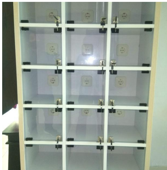
Gambar 11. Terminal Stasiun Charging
