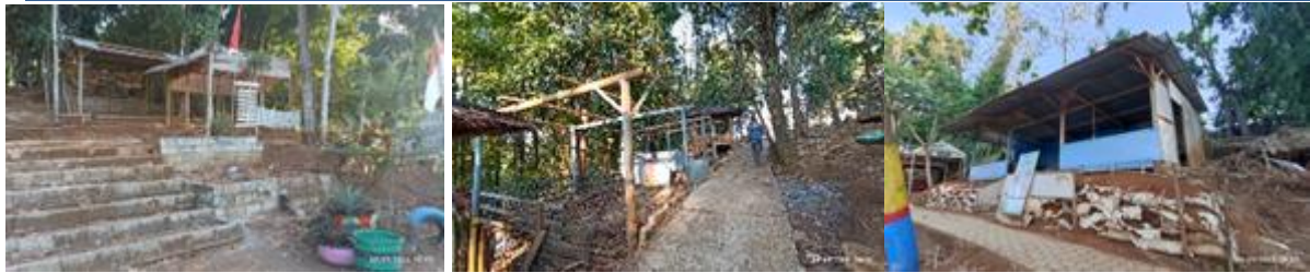
Gambar 4. Kios rusak atau tidak beroperasi
